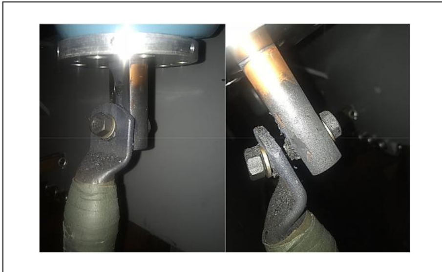
شکل (پ-۵): محل اتصال هادی به بوشینگ فاز V ترانسفورماتور
